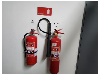
EXTINTOR PQS Y EXTINTOR CO2
