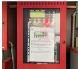
PANEL CENTRAL DE INCENDIO
