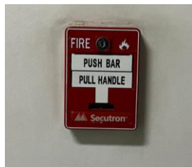
PALANCA DE INCENDIO
