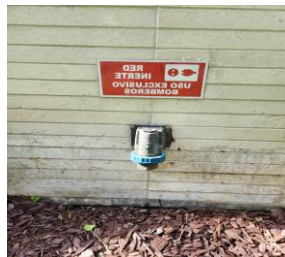
RED INERTE TOMA EXTERIOR
